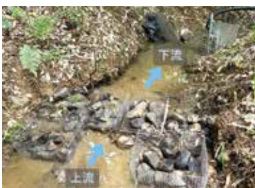
土砂を避ける堰堤
