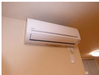
写真：1F 事務室空調機
